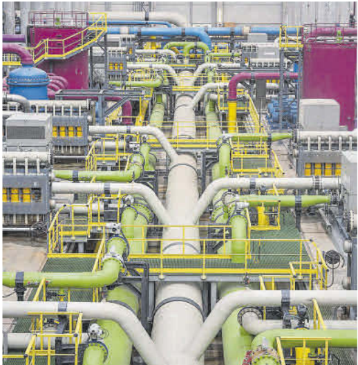
La planta desalinizadora de El Prat de Llobregat.
